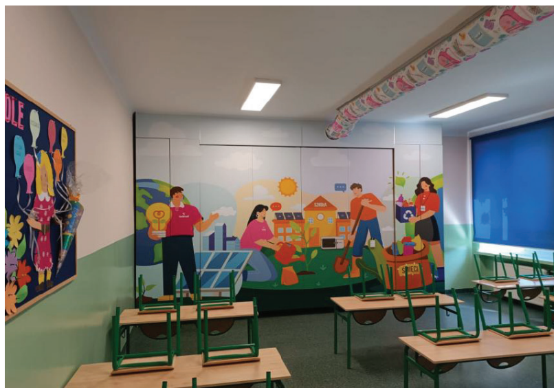
System wentylacji zainstalowany w wybranym pomieszczeniu edukacyjno-wychowawczym w szkole w Łędzinach. Centralę wentylacyjną umieszczono w zabudowie meblowej na końcu klasy. Widoczny kanał nawiewny oraz front zabudowy graficznie dopasowano wg wskázówek nauczycieli
