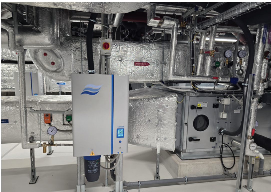
Nawilżacze zainstalowane w Muzeum Sztuki Nowoczesnej
