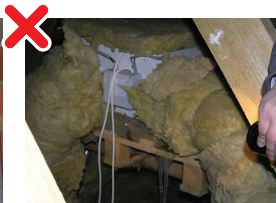
To nie żart – w jednym z domów lokalny fachowiec od wentylacji w taki sposób zaizolował system wentylacyjny
