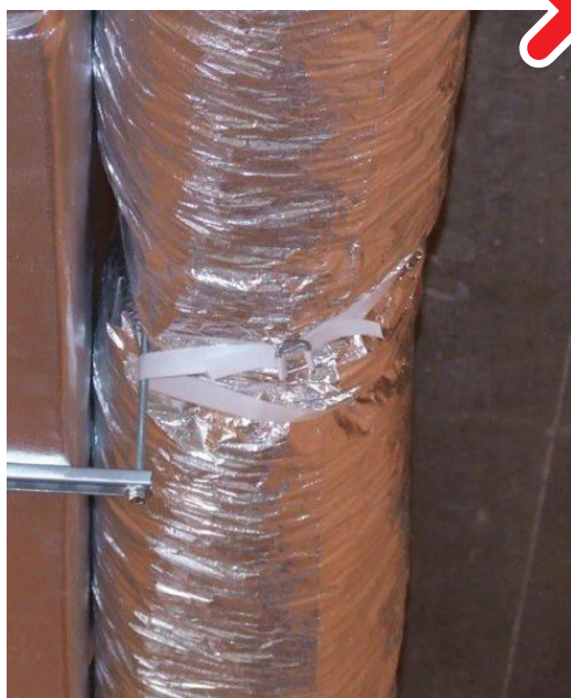
Opaska była tak mocno zacisnięta, że miękki kanał wentylacyjny flex został częściowo zgnieciony – takie zdławienie instalacji w kilku miejscach na pewno zaburzy pracę całego systemu wentylacji
