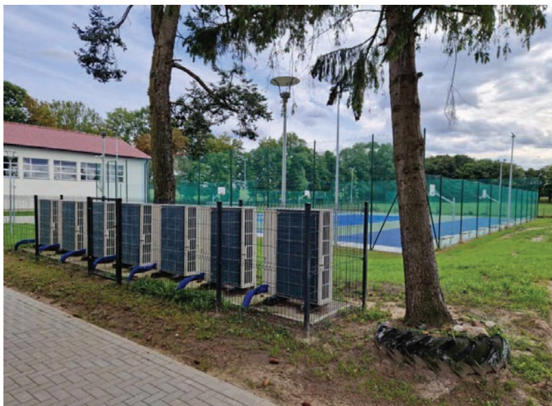
Kaskada pomp ciepła w szkole podstawowej w Lasecznie złożona z siedmiu jednostek o mocy 22 kW każda
