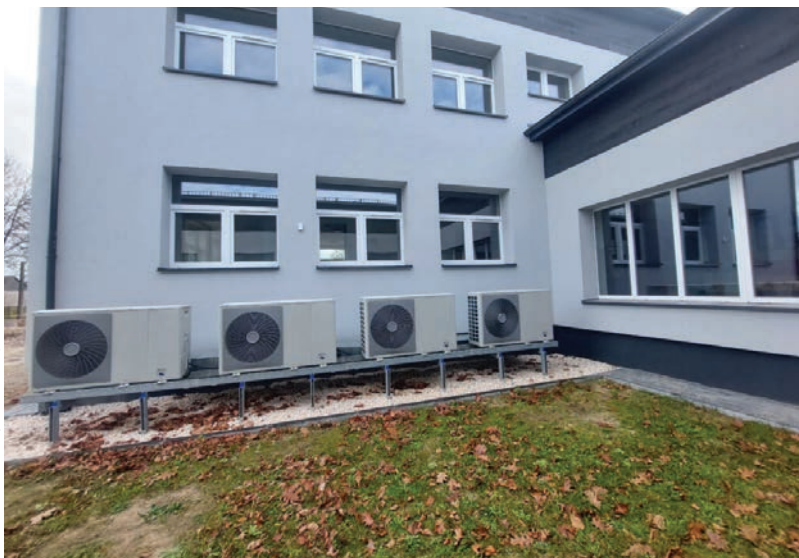
Kaskada pomp ciepła w Szkole Podstawowej im. Jana Pawła II w łódzkiej wsi Dęba koło Opoczna – wykonawca ustawił automatykę w taki sposób, aby pompy ciepła pracujące w kaskadzie włączały się proporcjonalnie do zapotrzebowania na energię cieplną
