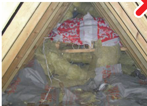
Spektakularny przykład niechlujnego wykonania izolacji – system rekuperacji w takich warunkach nie ma prawa działać prawidłowo
