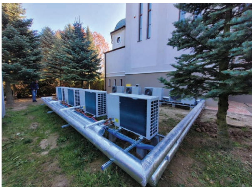
Kaskada pomp ciepła w Sanktuarium w Kałkowie-Godowie
