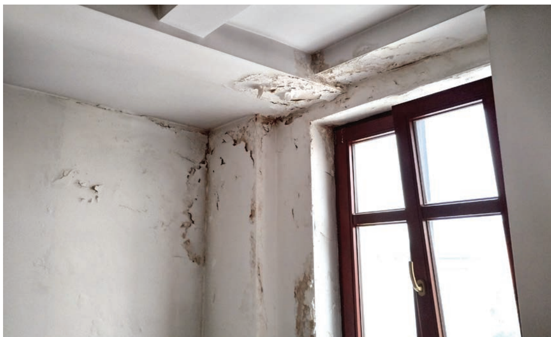
Zalegająca w strukturach dachu wilgoć może spowodować poważne uszkodzenia budynku
