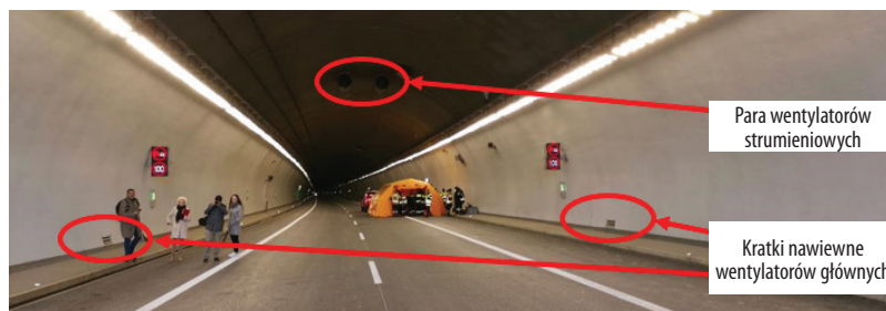
Wentylacja półpoprzeczna tunelu, źródło ARDOR
