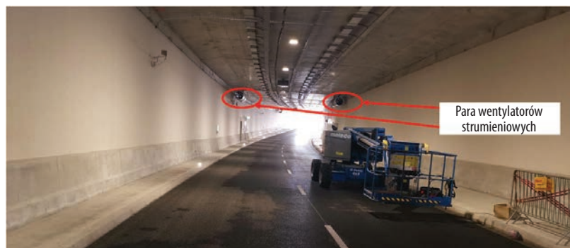
Wentylacja wzdłużna tunelu, źródło ARDOR
