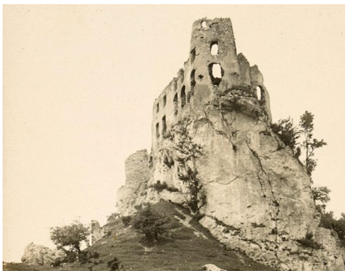
Źródło: Ilustracja udostępniona przez Jarosława Laseckiego Fot. 8. Ruina zamku w Bobolicach. Niebezpieczne spęknięcia skały jurajskiej pod ruiną baszty.
