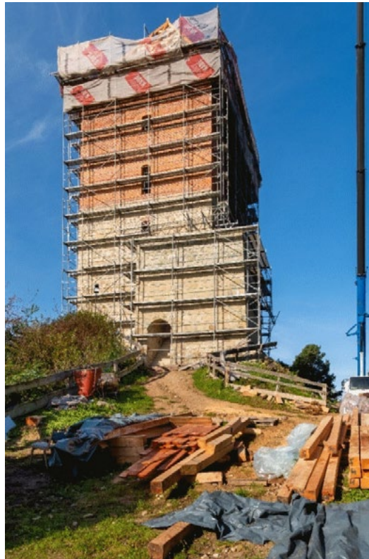
Źródło: KB-Projekty Konstrukcyjne, Fotograf: Bartłomiej Krcha. Fot. 2. Zamek w Melsztynie. Częściowa rekonstrukcja wieży mieszkalnej.
